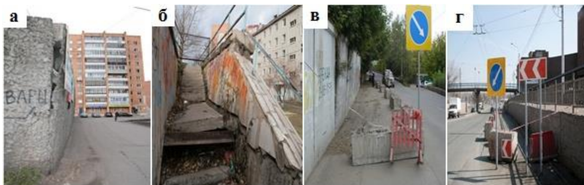
Рисунок 3. Подпорные стены, находящиеся в аварийном состоянии: а) ул. Петра Слоцова, 4; б) ул. Гусарова, 14; в) пер. Боготольский, 6; в) ул. Карла Маркса, 6
