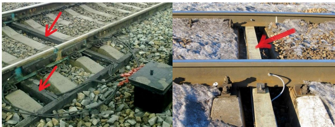
Рисунок 1. Деревянные бруски в шпальных ящиках
