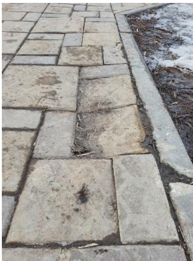
Рисунок 3. Нарушение ровности дорожного покрытия в связи с нарушением технологии укладки брусчатки
