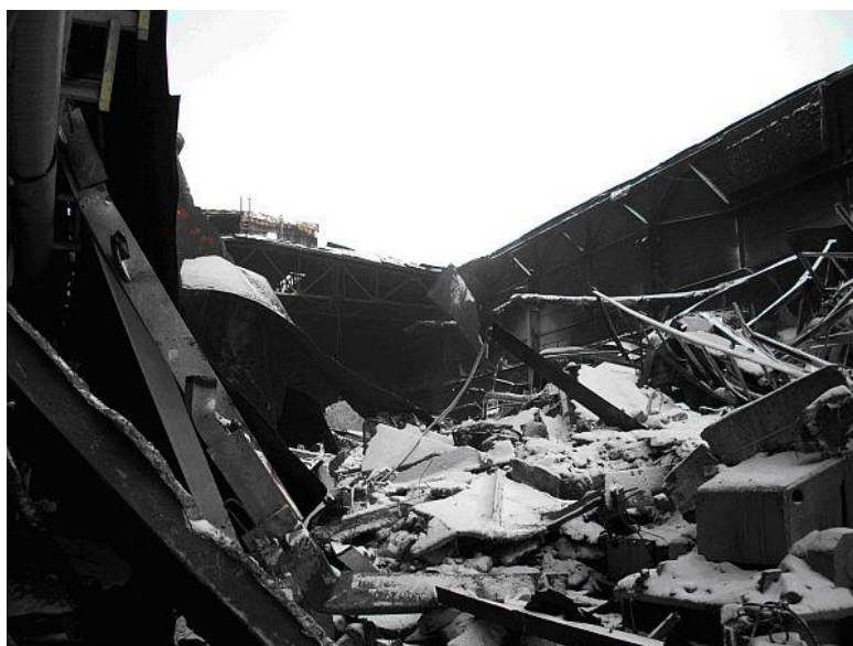
Рисунок 3. Обрушение покрытия травильного отделения здания ЛПЦ-5 ОАО «Магнитогорский металлургический комбинат»
