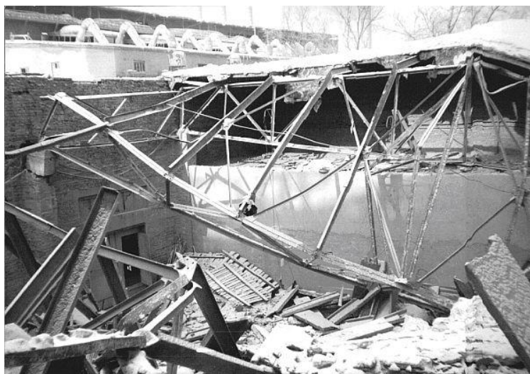
Рисунок 2. Обрушение покрытия цеха обжига на Магнитогорском цементном заводе
