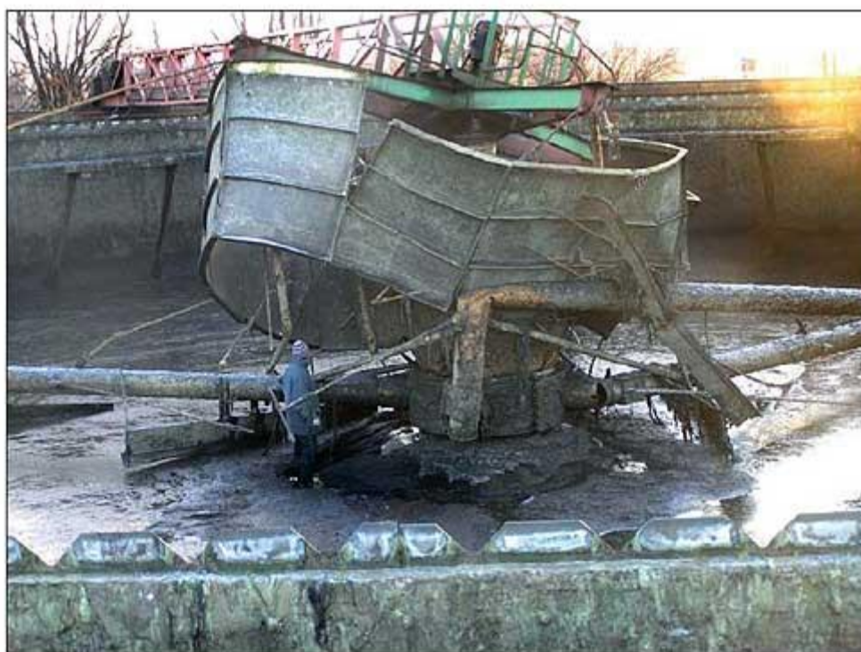
Рисунок 1. Первичный отстойник с разрушенным коррозией илоскребом
