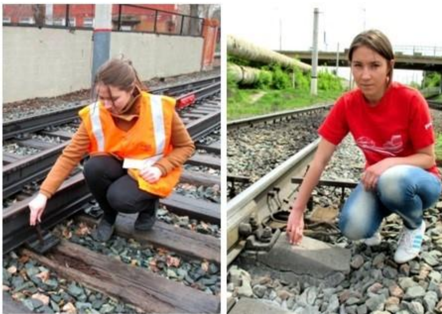
Рисунок 1. Сгнившая деревянная и лопнувшая бетонная шпала
