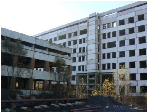
Рисунок 1. Общий вид здания палатного блока «А» главного корпуса городской многопрофильной больницы в г. Междуреченске
