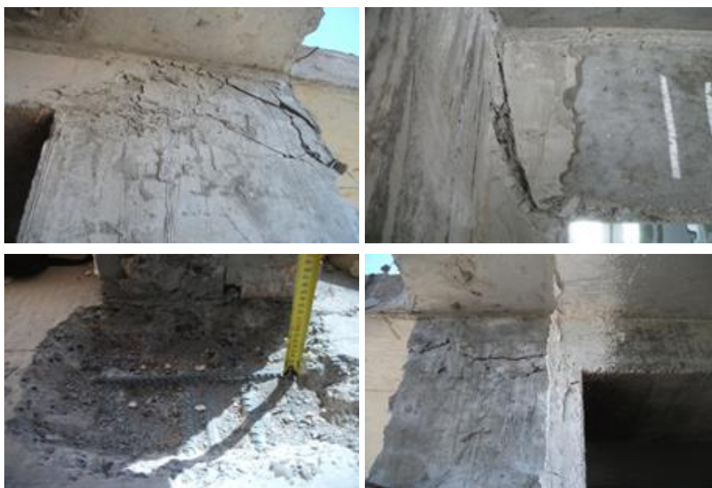
Рисунок 1. Характерные дефекты и повреждения, обнаруженные в строящихся монолитных зданиях: а - многочисленные трещины в монолитной колонне; б - трещина в балке перекрытия на опоре и разрушение защитного слоя бетона; в - разрушение защитного слоя бетона; г - трещины в колоннах
